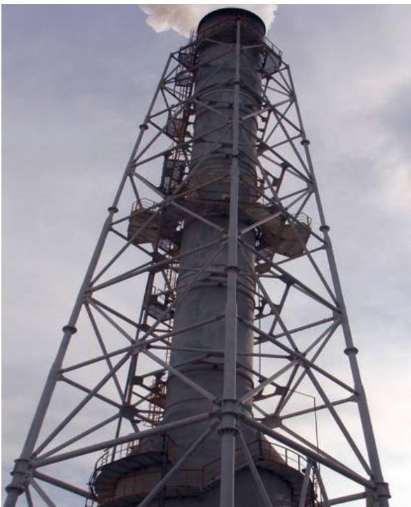
排煙脫硫系統(FGD)
