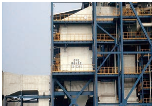
排煙脫硝系統(SCR)
