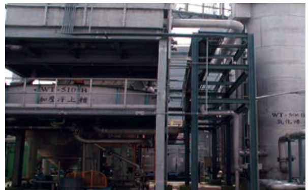
Fenton法廢水處理系統
