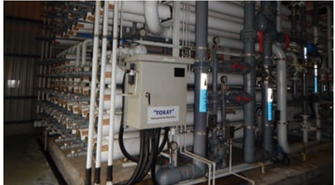
麥寮廠區PTA廢水處理場廢水薄膜回收系統
