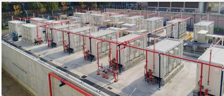
新港儲能設備
